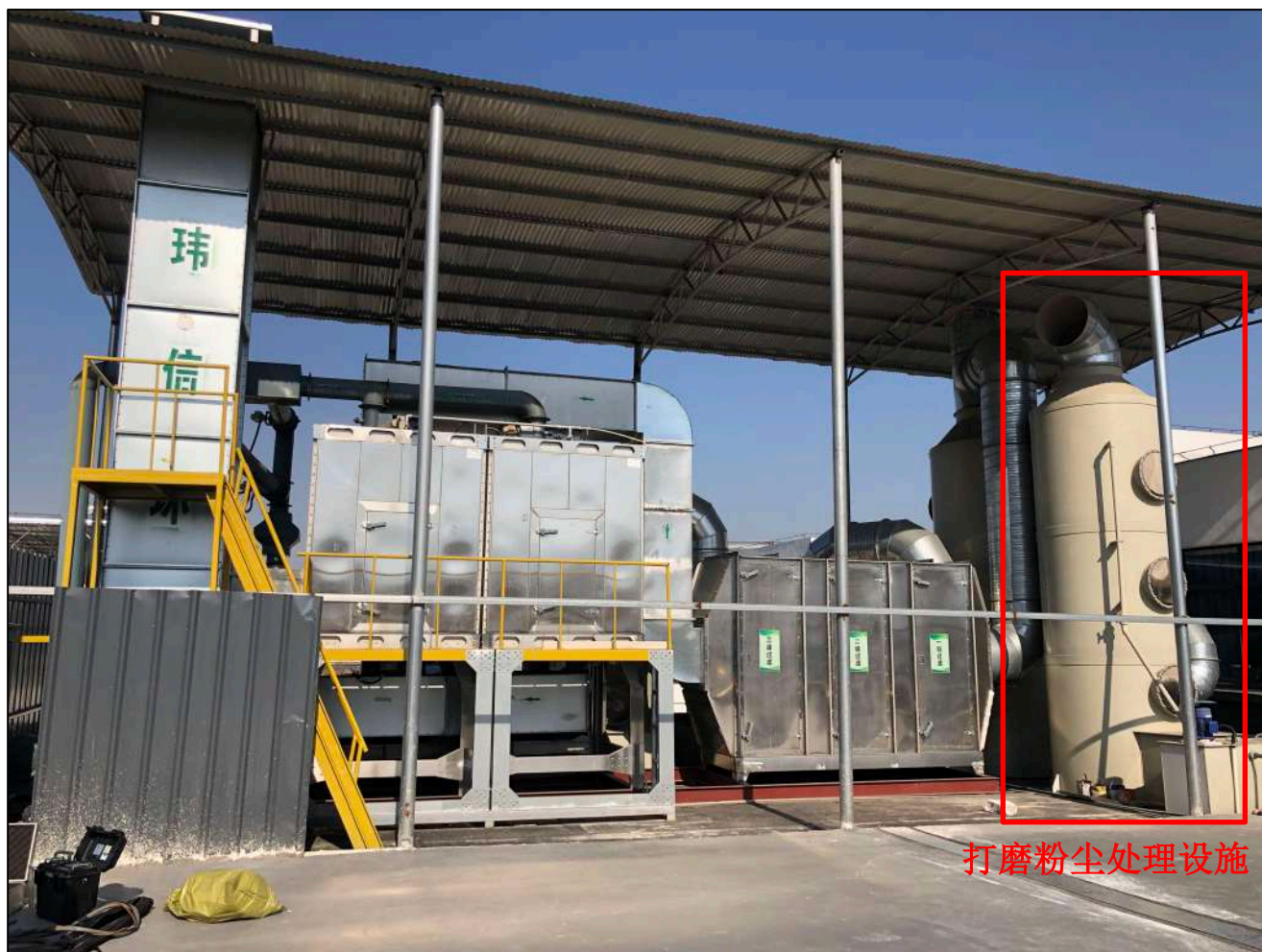
涂装废气、打磨粉尘处理设施
