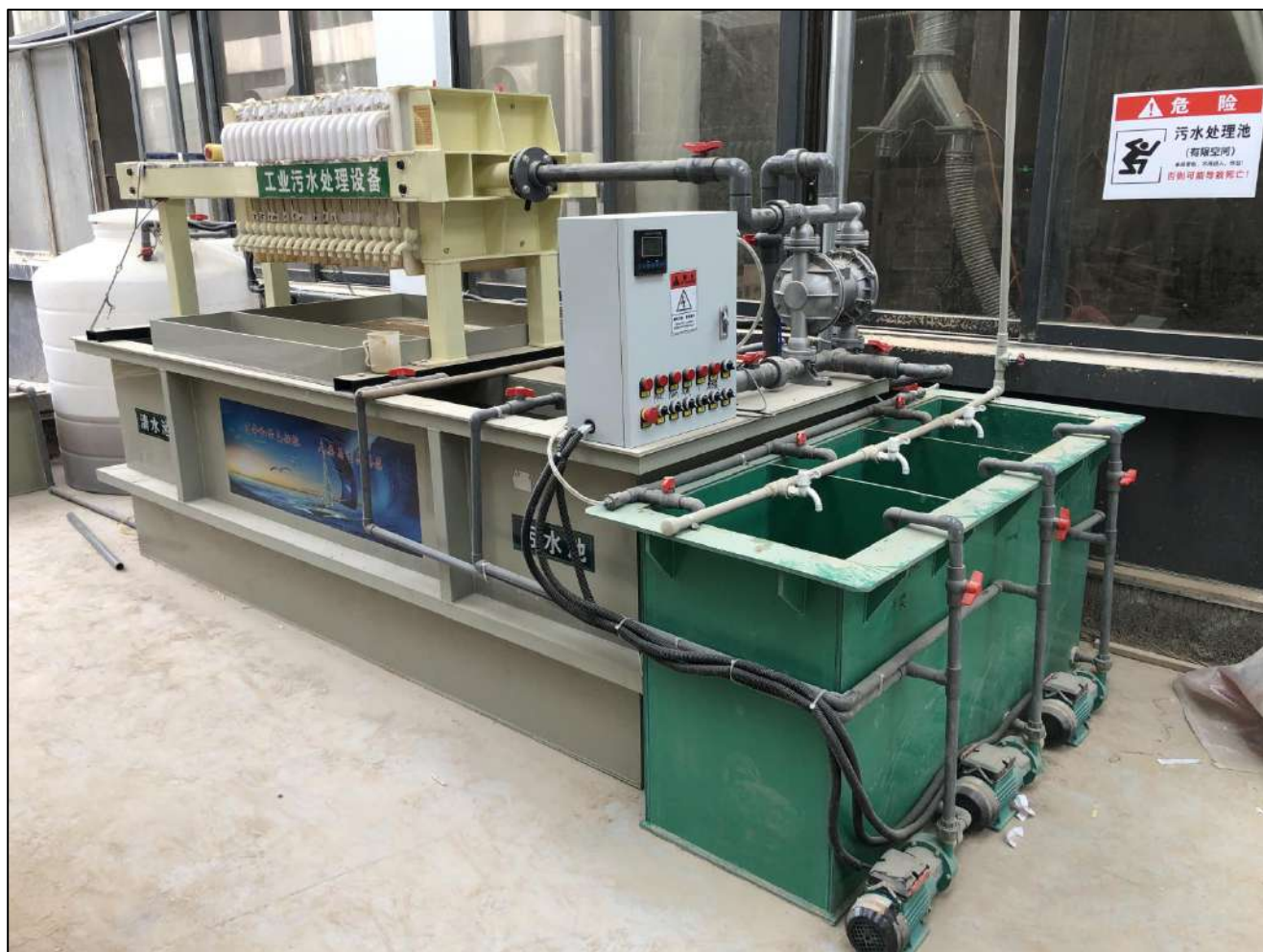
废水处理设施
