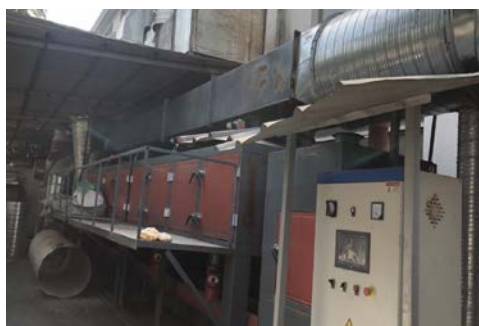
催化燃烧废气处理设施
