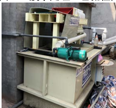
废水处理设施
