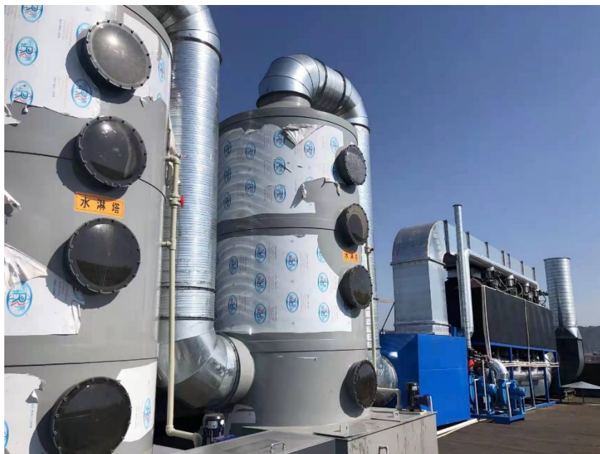
催化燃烧废气处理设施
