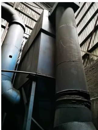
砂处理工序废气处理设施
