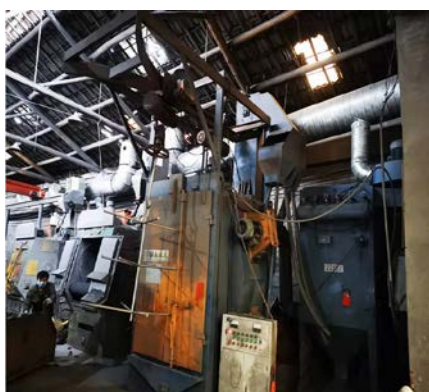
抛丸废气处理设施
