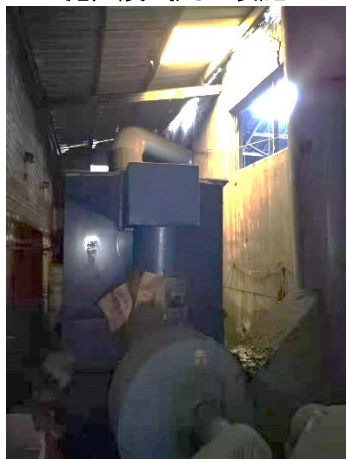
落砂废气处理设施
