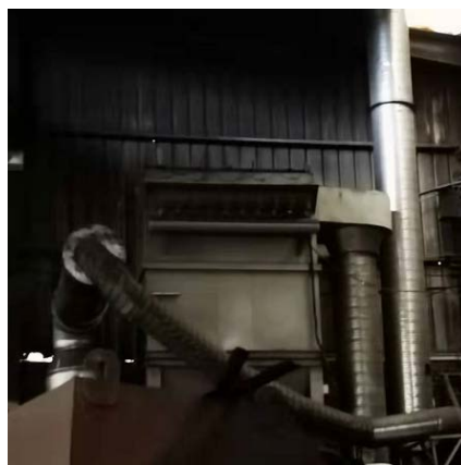
熔化废气处理设施
