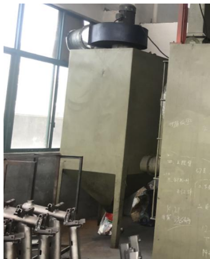
抛丸粉尘处理设施
