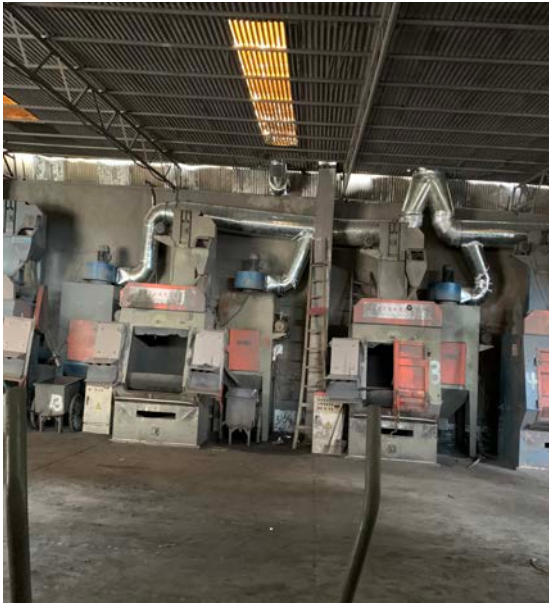
抛丸废气处理设施
