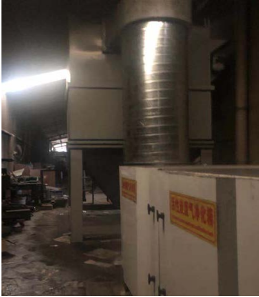
布袋除尘+活性炭吸附废气处理设施
