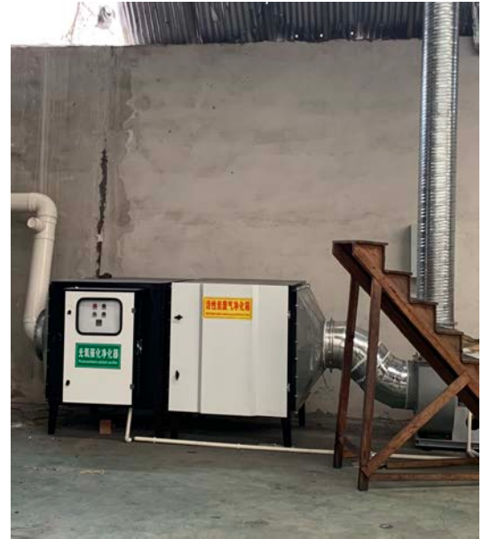
注塑废气处理设施
