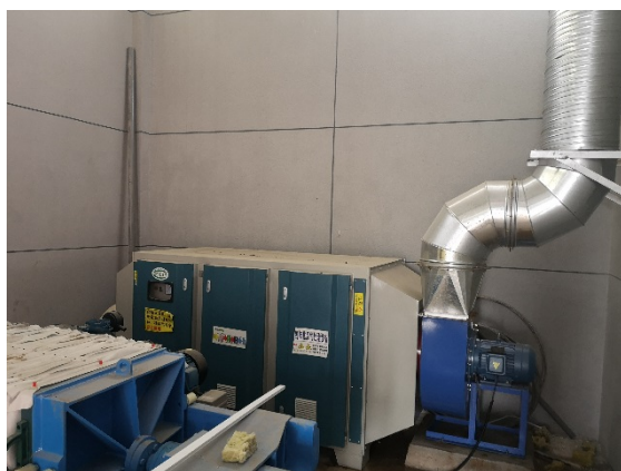
污水处理站废气处理设备
