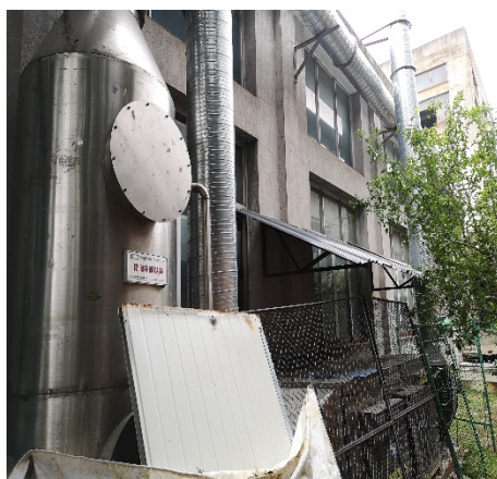
烘干废气处理设施
