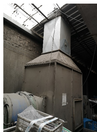
抛光粉尘处理设施
