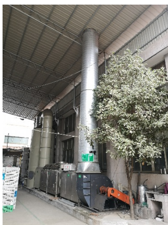
喷漆废气处理设施
