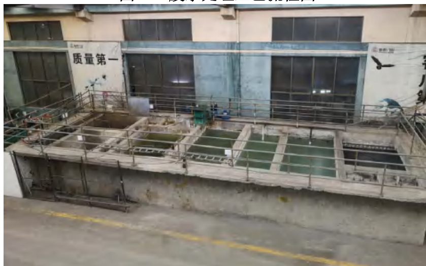
废水处理设施
