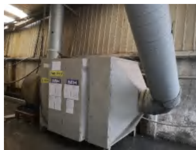
烘干废气处理设施
