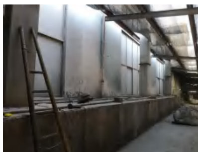
抛光粉尘处理设施
