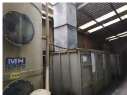
喷漆废气处理设施
