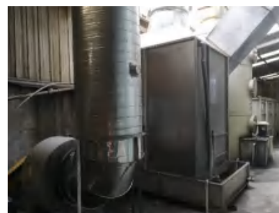
砂底粉尘处理设施
