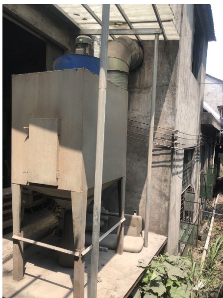
投料粉尘除尘器
