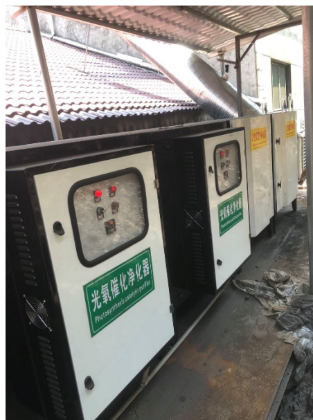
有机废气处理装置
