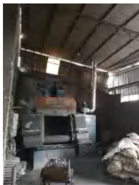
抛丸废气处理设施
