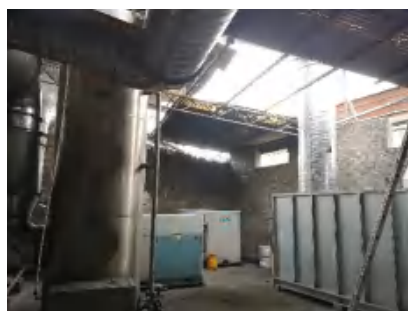
制芯（型）、浇铸废气处理设施
