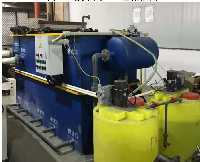
废水处理设施
