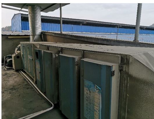
喷漆废气处理设施
