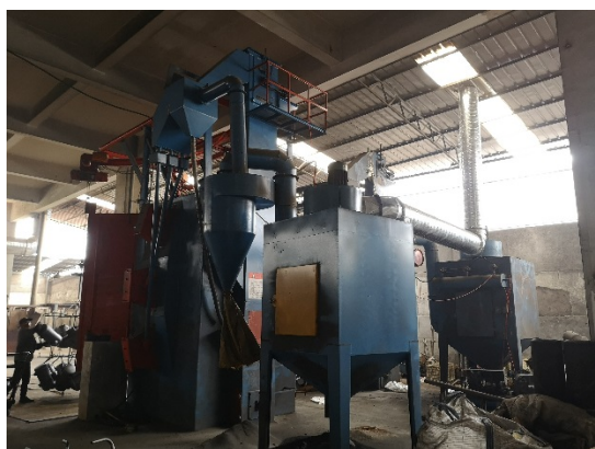
抛丸粉尘处理设施
