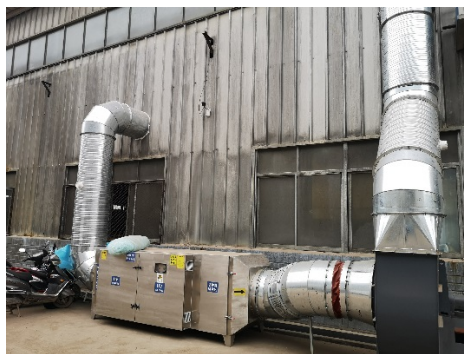
印刷废气处理设施
