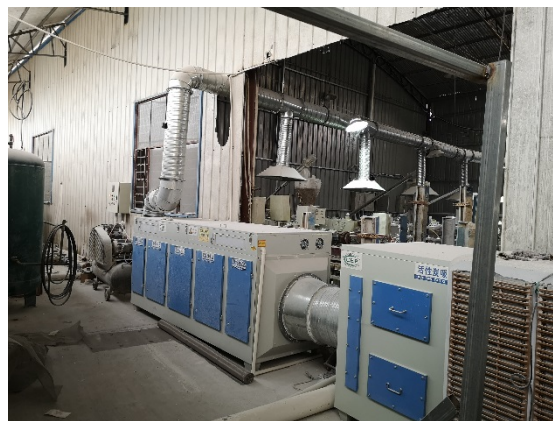
挤出废气处理设施
