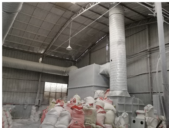
布袋除尘处理设施
