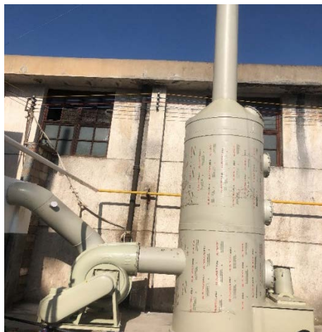
喷淋塔处理设施
