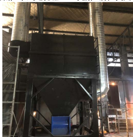
滤芯+布袋除尘回收系统处理设施
